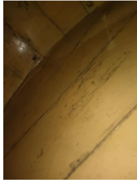
Gambar 5. 5 Kondisi dasar Tanki Penyimpanan setelah dibersihkan
